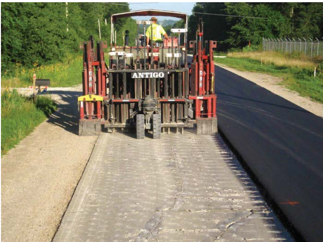
Modified Rubblization-occasional spalling
