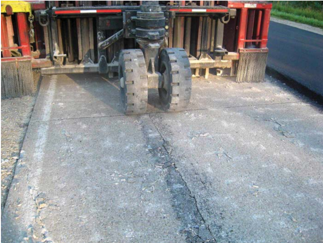
Modified Rubblization-occasional spalling
